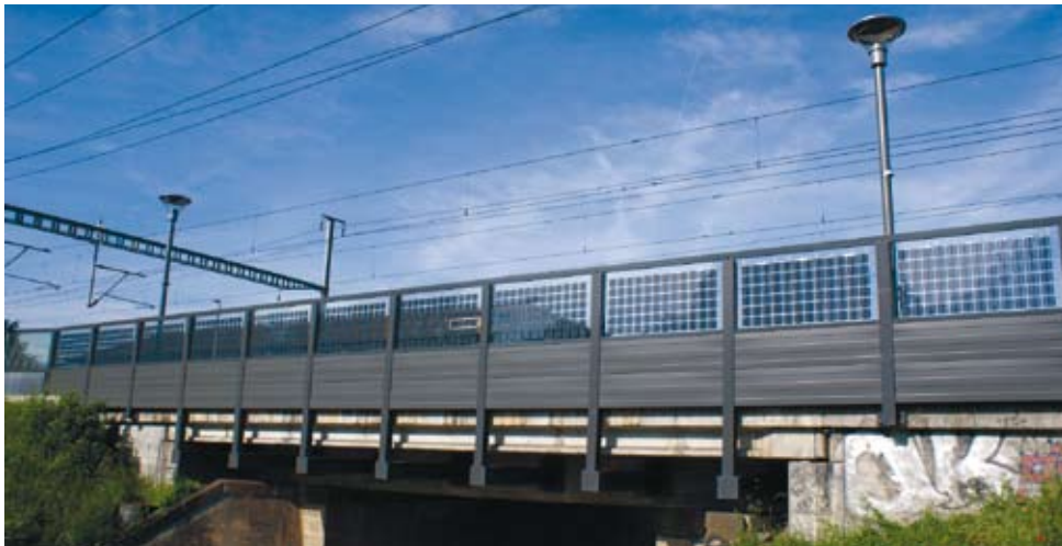
Neue Lärmschutzwand mit Solarzellen in Münsingen. Bild: zvg
